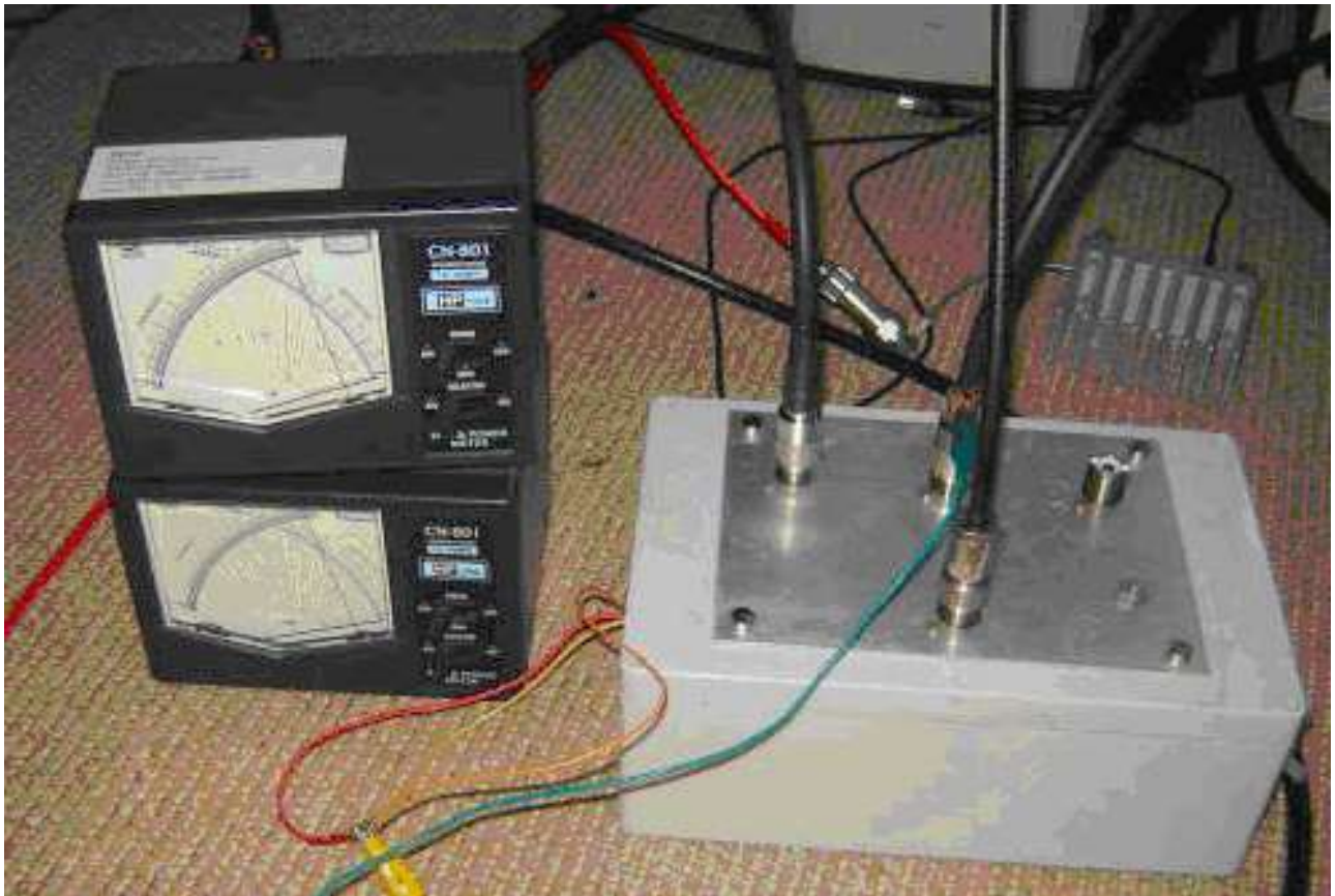
Testopstelling Roger PD1D: 40 Watt in en 2 maal 20 Watt uit
